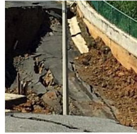
Impresionante hundimiento de terreno en urbanización de Ceiba
